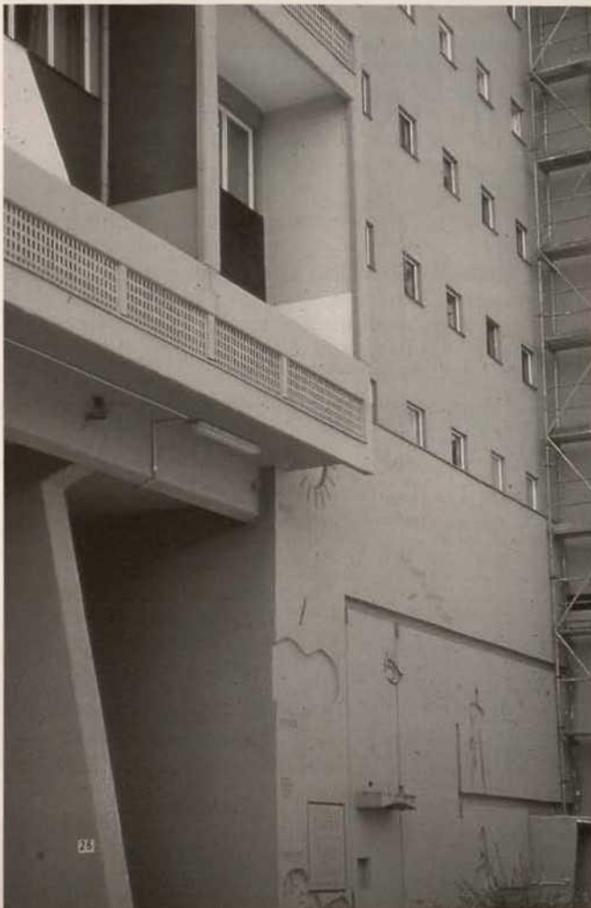
Abb. 15. Die 1956–58 im Rahmen der Berliner „Interbau“ von Le Corbusier entworfene, jedoch mit veränderten Proportionsverhältnissen errichtete „Unité d'habitation de grandeur conforme“. Die originalen Sichtbetonflächen sind nach der Sanierung unter Spachtel und Kunstharzfarbe verschwunden (Foto H. Schmidt)
