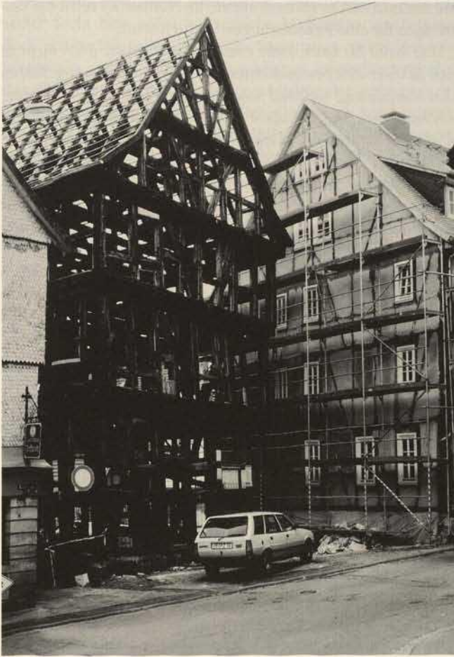
Abb. 3. Alsfeld (Hessen). Entkerntes Fachwerkgebäude während der Sanierung. Das rechts nebenstehende Haus bereits saniert. Foto 1988
