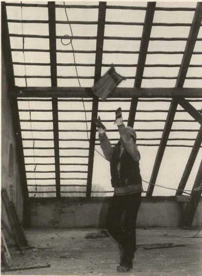
Abb. 11. Abdeckung von Dachziegeln
