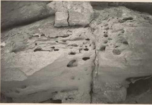
Abb. 1. Lochbildung durch differentielle Erosion Fig. 1. Pitting
