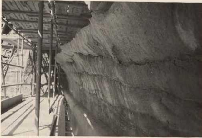
Abb. 9. Zustand des oberen Gesimses
