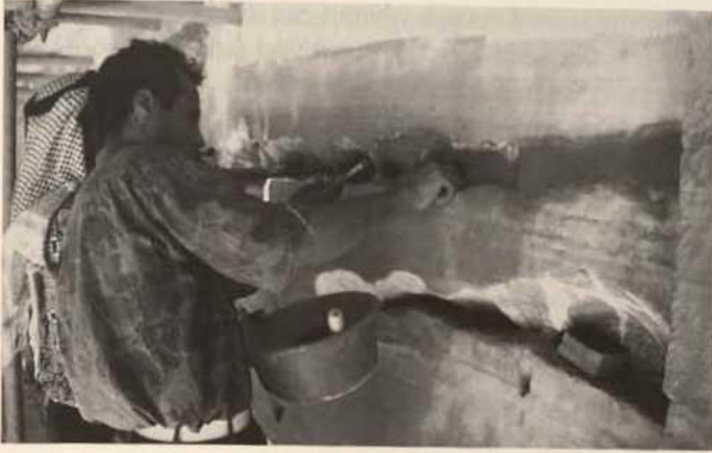
Abb. 8. Alveolarauswitterung: unten nach Abarbeitung der Salzkruste, oben Antrag des Reparaturmörtels
