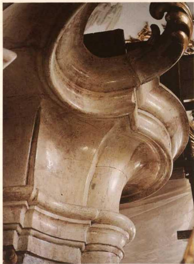
2 Regensburg, Basilika Unserer Lieben Frau zur Alten Kapelle, Hochaltar, Detail, Originalfassung mit rekonstruierter Lackbeschichtung
