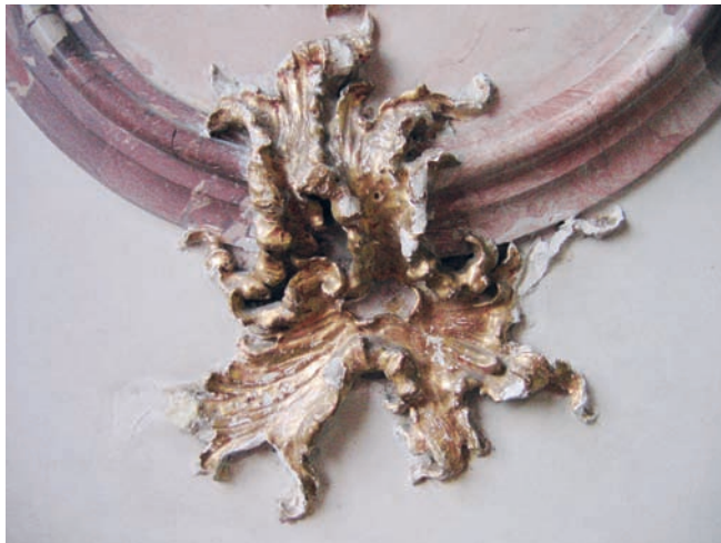
Abb. 4. Würzburg, Residenz, Kaisersaal: mechanische Schäden an den Wandstukkaturen.
