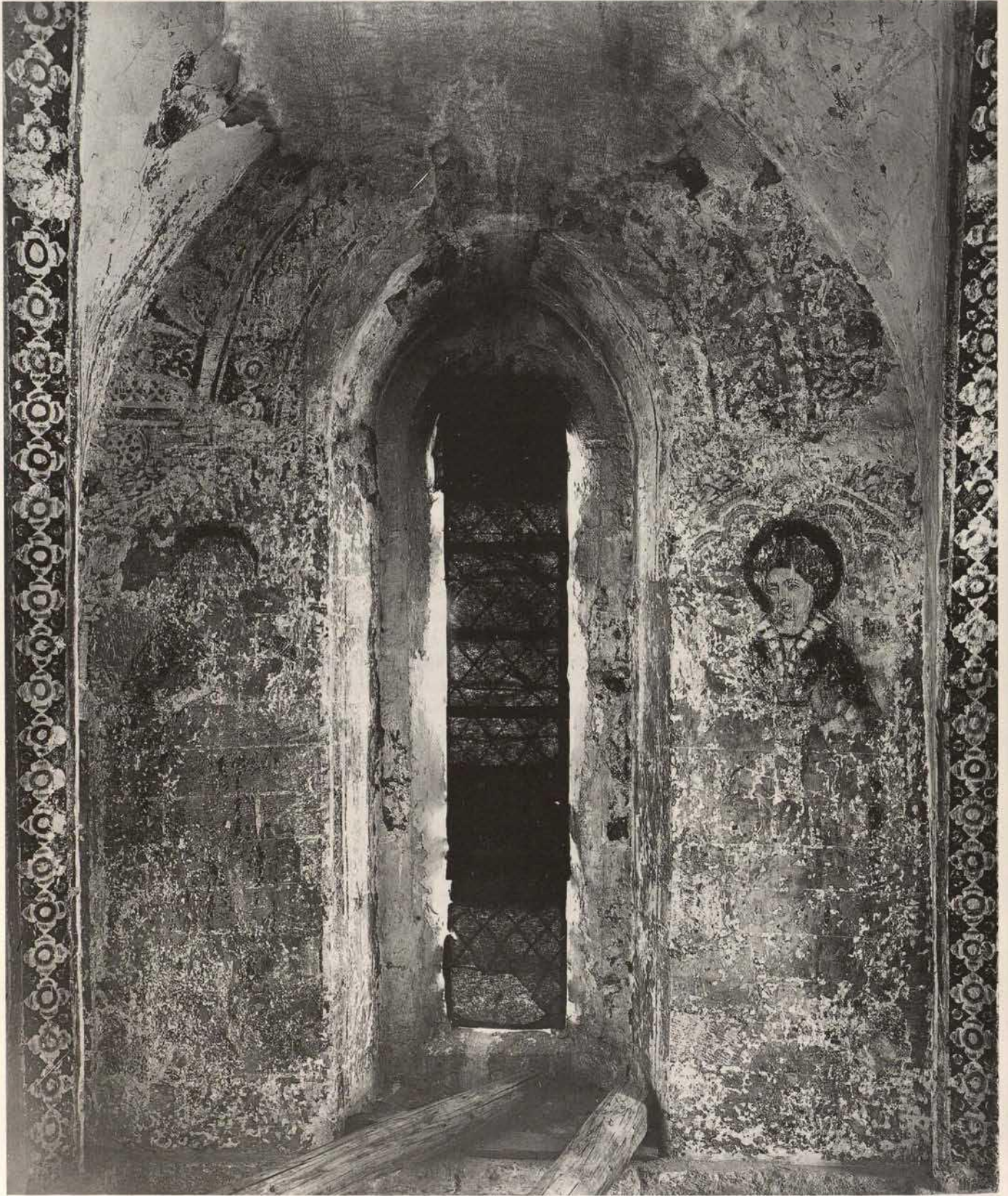
Abb. 131. Sion/Sitten, Notre-Dame-de-Valère, Chor, Fensterzone, Johannes der Täufer und Maria Magdalena: Zustand von 1898 mit großen Freilegungsverlusten und Resten der älteren, durch ungeeignete Arbeitsmethoden auf Kosten der figürlichen Malerei freigelegten Quadermalerei (13. Jh.).
