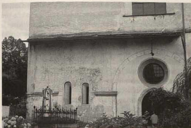
Abb. 150. Millstatt, Kärnten, ehem. Stiftskirche, Westfassade, altes Schutzdach über der nach Abnahme und Übertragung der Malschicht (1964) vor Ort verbliebenen Unterzeichnung der Weltgerichtsszene von Urban Görttschacher (1518; Zustand 1970).
