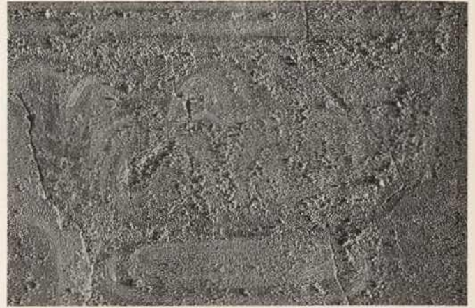
Abb. 171. Lambach, Stiftskirche, ehem. Läuhaus, nördliche Westwand, Feld 21, Detail: Kapitell mit erheblichem Schadensbild durch hygrokopische lösliche Salze (Zustand 1974).
