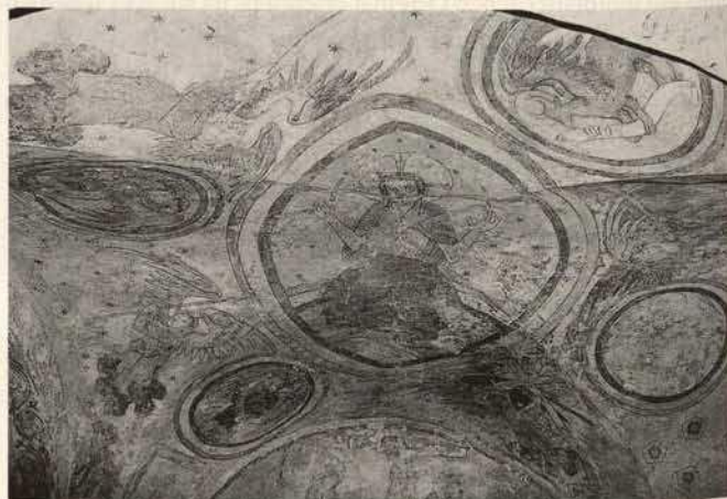
Abb. 233. Kriebstein, Burgkapelle, südöstliches Gewölbe: Zustand der nach 1933 restaurierten und in der Folge stark verbräunten Malerei während der Konservierung (1993).
