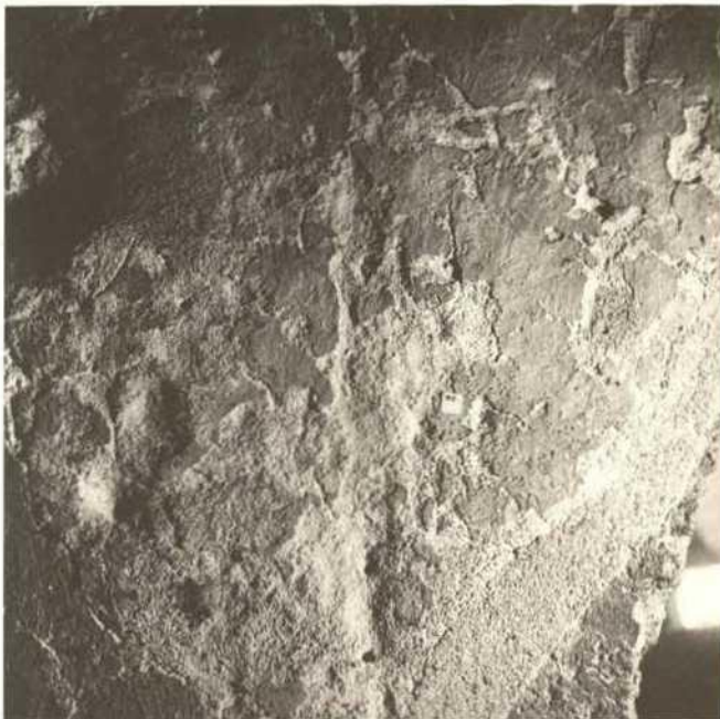
Abb. 114. Steinbach, Einhards-Basilika, Schadensdokumentation: aufgebrochene und absandende Mörteloberflächen (Phase 2).
