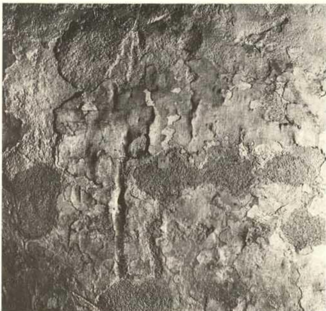
Abb. 112. Steinbach, Einhards-Basilika, Schadensdokumentation: sich trennende und deformierte Malschichten der Phasen 1, 3 und 8.
