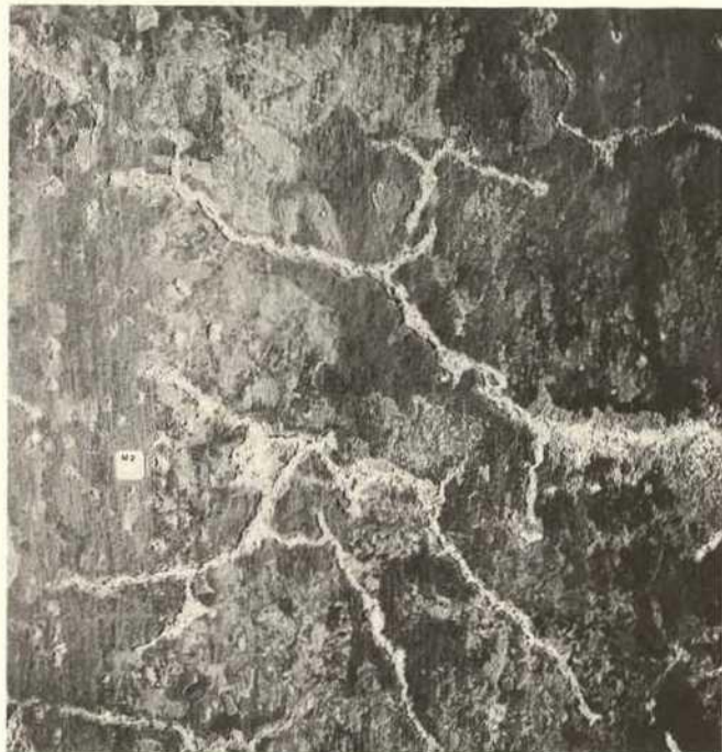
Abb. 113. Steinbach, Einhards-Basilika, Schadensdokumentation: aufgebrochene und absandende Mörteloberflächen im Bereich der Apsis (Phase 1).
