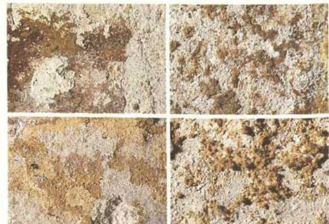
Abb. 170a-d. Regensburg, St. Emmeram, Ringkrypta, Verbindungsgang, Schadensbilder: kristalline Gipsablagerungen, beginnende Pustelbildung (a-d) und pudrige Auflösung der Farbschicht (d; 1993).
