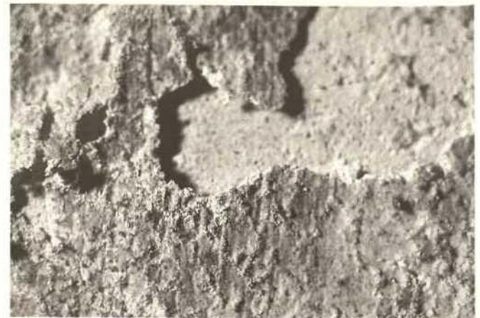
Abb. 172. Regensburg, St. Emmeram, Ringkrypta, Verbindungsgang zur Ramwoldkrypta, Nordwand, Detail: hohl liegende und teilweise abgängige Kalkgrundierung mit Malschicht, im unteren Bildbereich Pustelbildung durch Gipskristallisation (1993).
