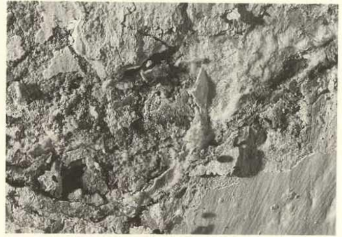
Abb. 171c. Regensburg, St. Emmeram, Ringkrypta, südlicher Ringgang, Außenwand, salzinduzierte Putz- und Malschichtschäden im Bereich des gerahmten Inschriftstreifens vor der Konservierung (Detail aus Abb. 171b).
