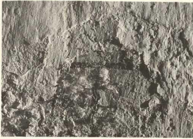
Abb. 171b. Regensburg, St. Emmeram, Ringkrypta, südlicher Ringgang, Außenwand, salzinduzierte Putz- und Malschichtschäden im Bereich des gerahmten Inschriftstreifens vor der Konservierung (Detail aus Abb. 171a).
