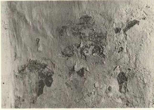
Abb. 171a. Regensburg, St. Emmeram, Ringkrypta, südlicher Ringgang, Außenwand, salzinduzierte Putz- und Malschichtschäden im Bereich des gerahmten Inschriftstreifens vor der Konservierung (Zustand 1987).
