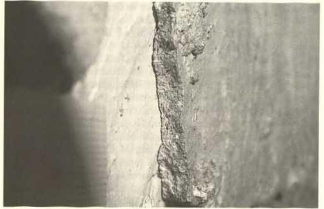
Abb. 205. Aosta, Kathedrale, Dachraum des Mittelschiffs, Südseite, Feld S3 noch vor der Freilegung: unter dem dicken Malputz (getüncht und verschmutzt) tritt der geweißte und sehr saubere Unterputz zutage (Zustand 1989).
