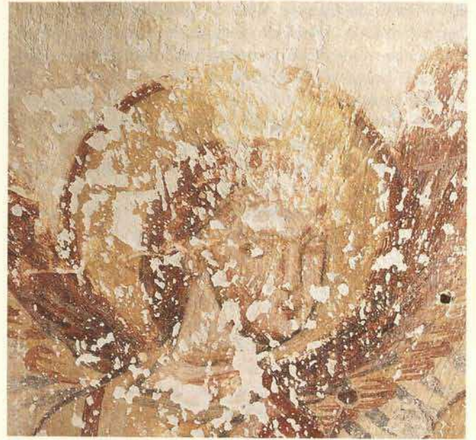
Abb. 318b. Fulda-Neuenberg, St. Andreas, Krypta, Nordwand, Detail: Kopf des 2. Engels (freigelegter Zustand) mit zum Teil vollständig erhaltener Malschicht (1996).
