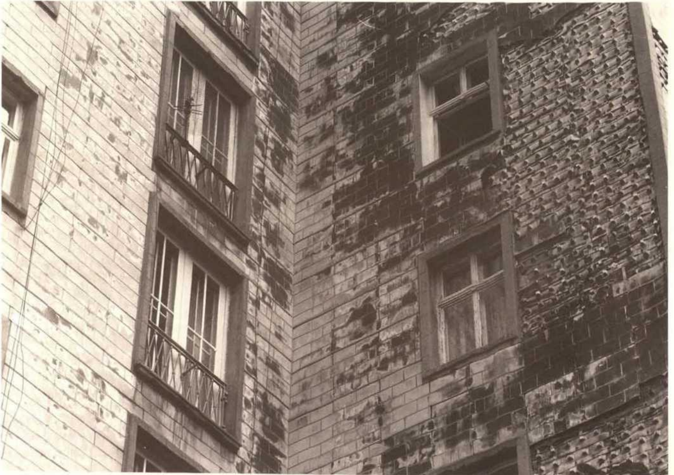
Fassadenausschnitt: die ursprüngliche Keramikbeleidung ist an vielen Stellen bereits durch Kunststoffplatten ersetzt worden, die ebenfalls wieder abgängig sind (Karl-Marx-Allee 123)
