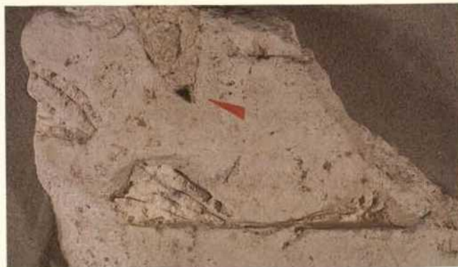
Abb. 149. Stuttgart, Landesdenkmalamt, Stuckfragment aus der ehem. Klosterkirche Großkornburg (Mag.-Nr. 407/408), Detail mit Staubablagerungen in den Vertiefungen geschlossener Ornamente: Beleg für Veränderung noch vor der ersten Farbfassung.
