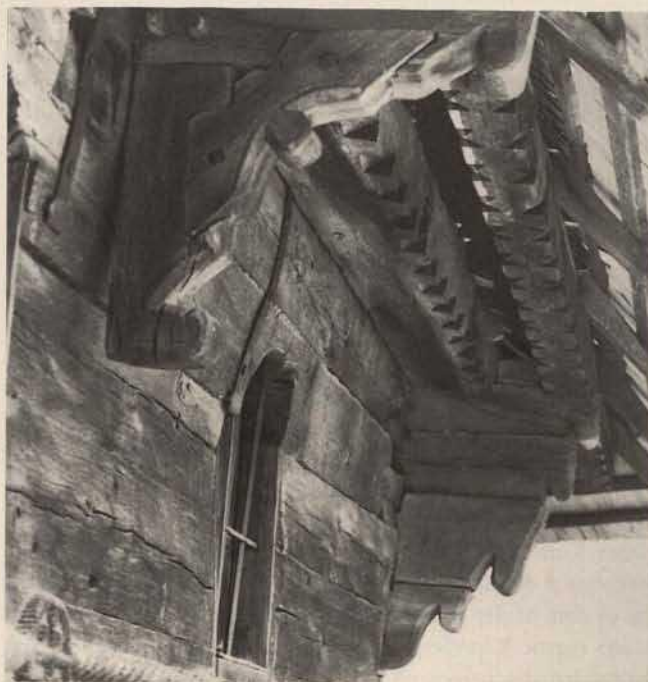
Kirche zu den hl. Erzengeln in Rogoz, Ausbildung der Traufe / Eglise des Saints-Archanges à Rogoz, égouts
