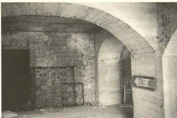
6 Nizza Monferrato, Piazza, Gebäude neben dem Rathaus, Umbau im Erdgeschoß. Irreversible Änderung des Tragsystems
