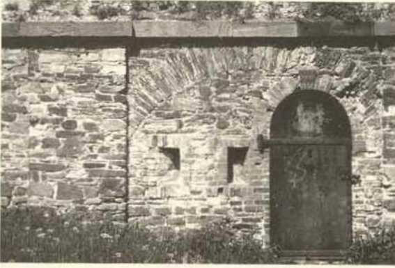
7 „Ausblühen“ von Salz aus einer Mauer (Festung Ehrenbreitstein). Salz wurde im Inneren der Mauer gelöst, in einem Konzentrationsgradienten transportiert und an der Oberfläche durch einen steilen Gradienten im Wasserdampfdruckausgefällt: Irreversibler Vorgang
