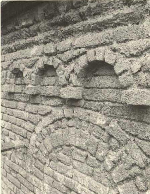
21 Ilimünster, ehem. Klosterkirche, Zerstörung der originalen romanischen Oberflächen der Fassaden wegen Neuverputzung nach VOB. Die Maßnahme ist auch technisch fragwürdig, da diese Verordnung an der Technologie von Neubauten orientiert ist.
