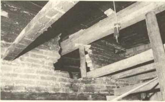
14 Krumbach, Hürbener Schließchen, Verspannung des Bauwerks vor Beginn der Bauarbeiten nach Gewohnheit der Baufirma ohne Berücksichtigung der Denkmaleigenschaften. Unnötige, erhebliche Beschädigungen der wenigen erhaltenen spätgotischen Wände.
