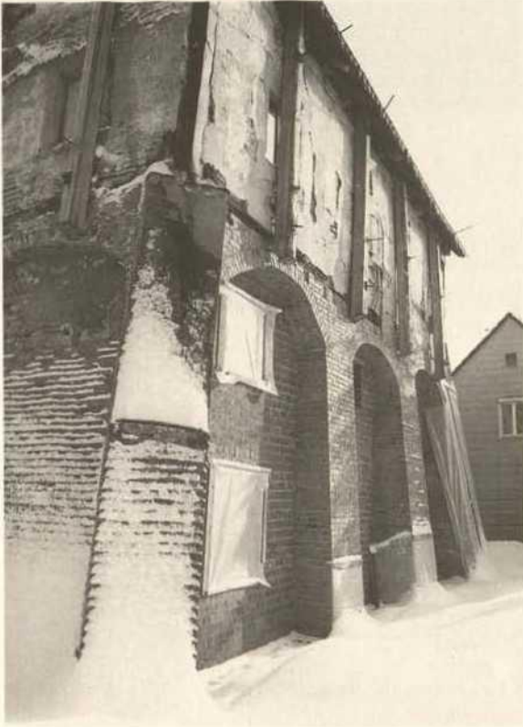
18 Krumbach, Hürbener Schloßchen, Unterbau, Westseite, nach völliger Erneuerung im Bereich des „Tunnels“ (Abb. 16). Die alten, schiefstehenden Schildwände sind durch neue, senkrechte ersetzt, die Pfeiler nahezu senkrecht erneuert (1982).
