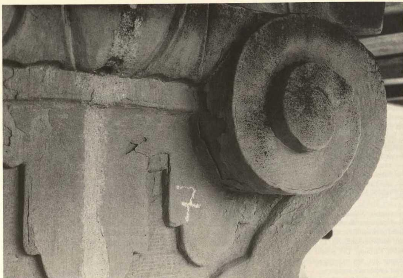
Abb. 1. Ausschnitt einer Volute; die Schadensbilder umfassen Schalenbildung, Absanden und Risse entlang von Kanten
