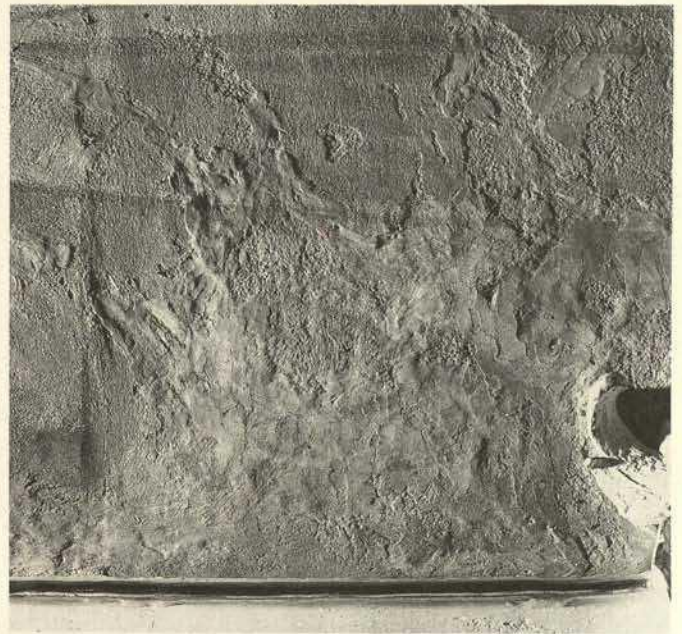
Abb. 31. Kapelle, Nordseite; ältere Putzergänzungen und Retuschen im Streiflicht; mangelhaft integriert in die originale Oberfläche, Vorzustand
