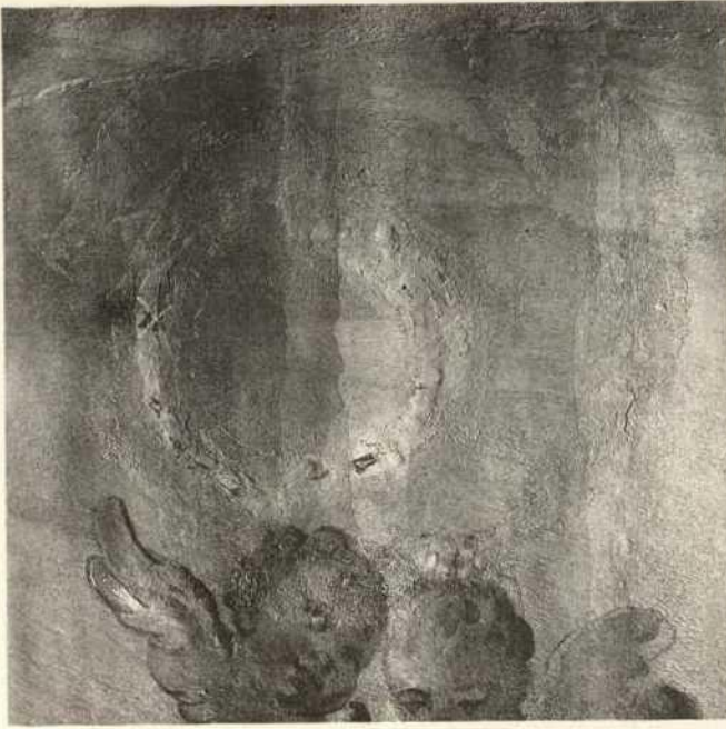
Abb. 34. Wasserschaden, z. T. bei älteren Restaurierungen mit Gipsputz überzogen und farblich eingestimmt
