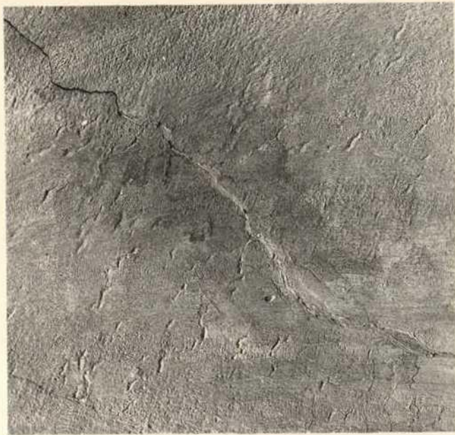
Abb. 2, 3. Risse im Freskobereich mit dachförmig sich aufstellender Malschicht
