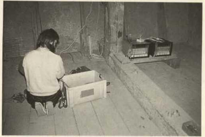
Abb. 7. Verkabelung und Anschluß im Dachraum Fig. 7. Cables and connections in the roof
