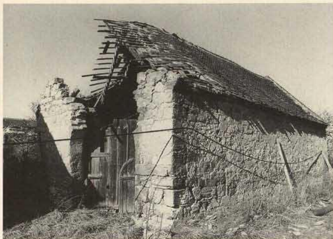
Abb. 45. Hauptstraße 152, „Zollnerhof“, ruinöse östliche Scheune von Südwesten, gemischtes Kalksteinquader- und Bruchsteinmauerwerk unter Verwendung von Ziegeln für Traufen, Ortgang und Torbogenlaibung.
