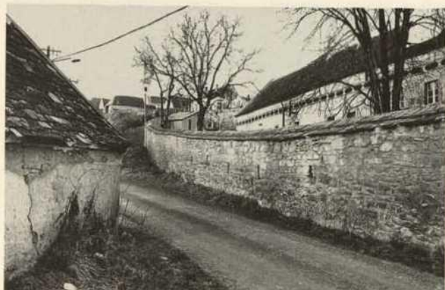
Abb. 111. Mühlenanwesen, westliche Umfassungsmauer mit Schießcharten, vermutlich Reste der Befestigung um den hochmittelalterlichen Ortskern bewahrend.
