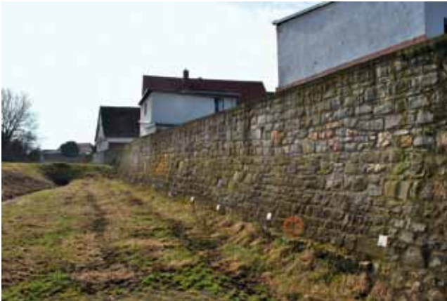
Abb. 3: Barby an der Elbe (Sachsen-Anhalt). Die Hochwasserschutz-Wand erscheint als „aufgefrischte“ historische Stadtmauer; der nähere Augenschein enthüllt jedoch, dass es sich um einen Neubau handelt, für den die historische Substanz eines herausragenden Denkmals geopfert wurde
