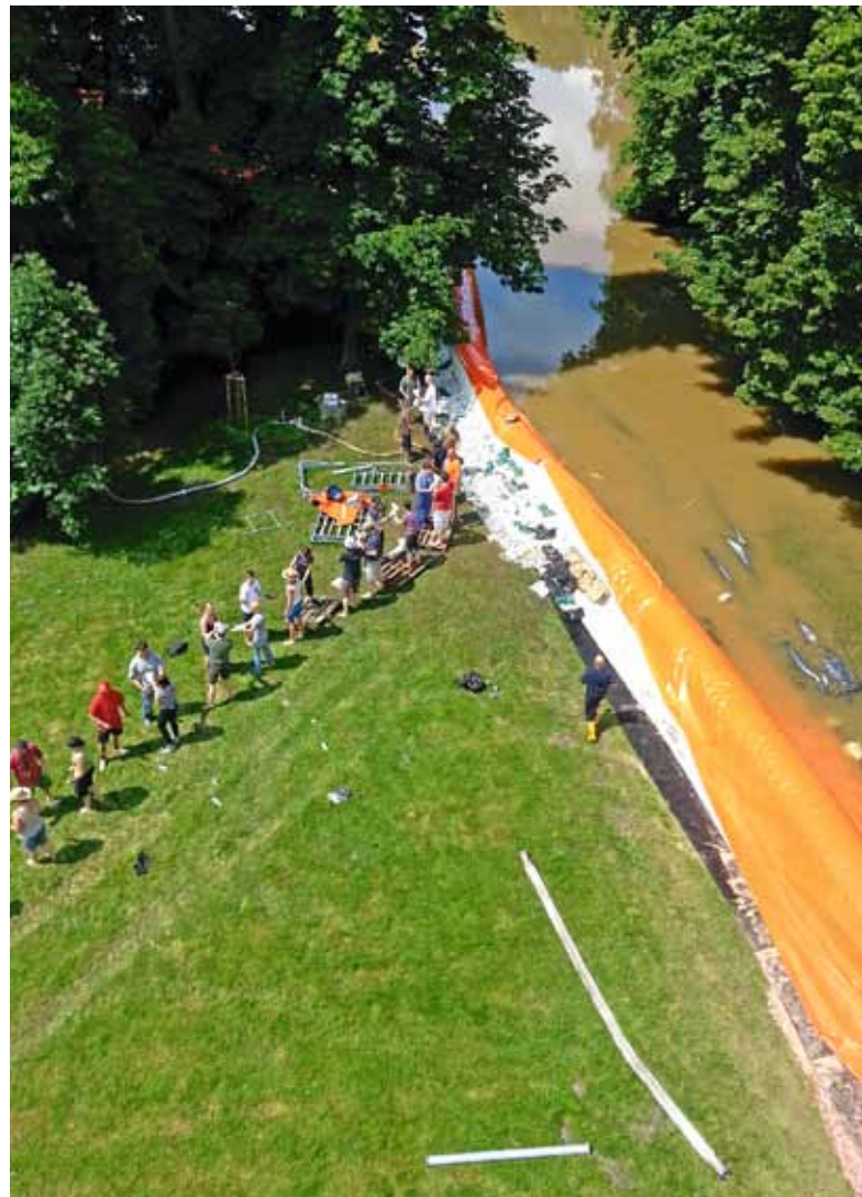
Abb. 6: Aufgebauter Mobildeich im Bereich des Schlosses Luisium beim Hochwasser im Juni 2013
