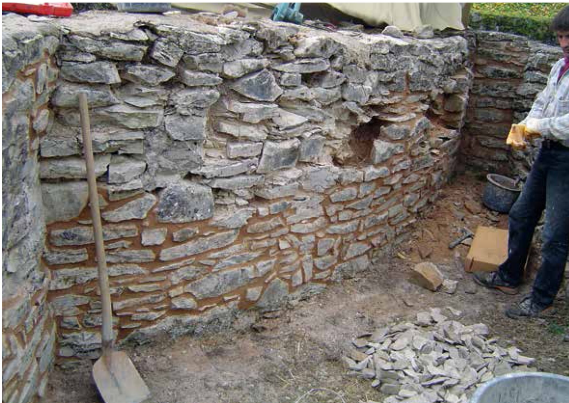
10 Ausgelaugtes Mauerwerk im sogenannten Burgus von Burgsalach, Mittelfranken, während des ersten Sanierungsversuchs 2012. Bayerisches Landesamt für Denkmalpflege; C. S. Sommer.
