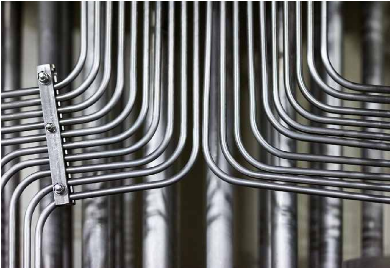
Abb. 2: Bernhard Ludewig: Kernkraftwerk Krümmel. Rohrleitungen im Steuerstab-Antriebsraum. April 2017.
