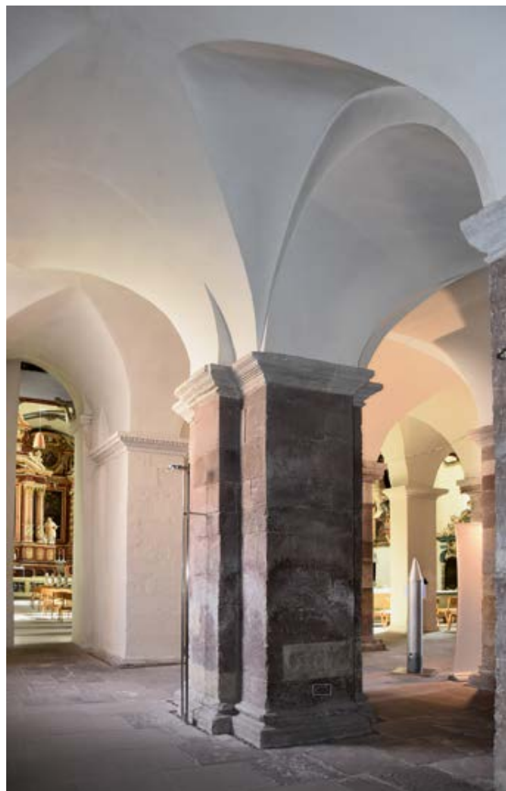
25 Nordöstlicher Pfeiler mit weißgrauen Gipskrusten im Erdgeschoss des Westwerks, 2018
