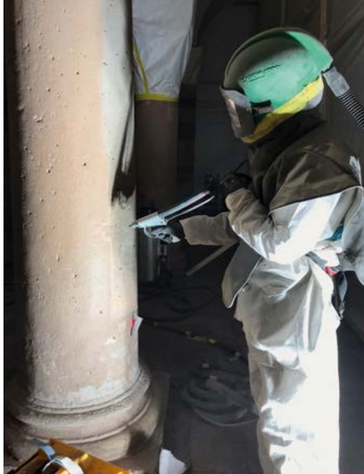
27 Entfernung der Beschichtung auf den Säulen und Basen des Westwerk-Erdgeschosses durch die Restauratorin Peña Moradillo, 2020
