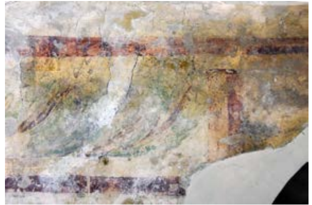
20 Wandmalerei auf der Südwand im Erdgeschoss des Westwerks: Verbräunung der Malerei durch Überfestigung (Detail), 2018
