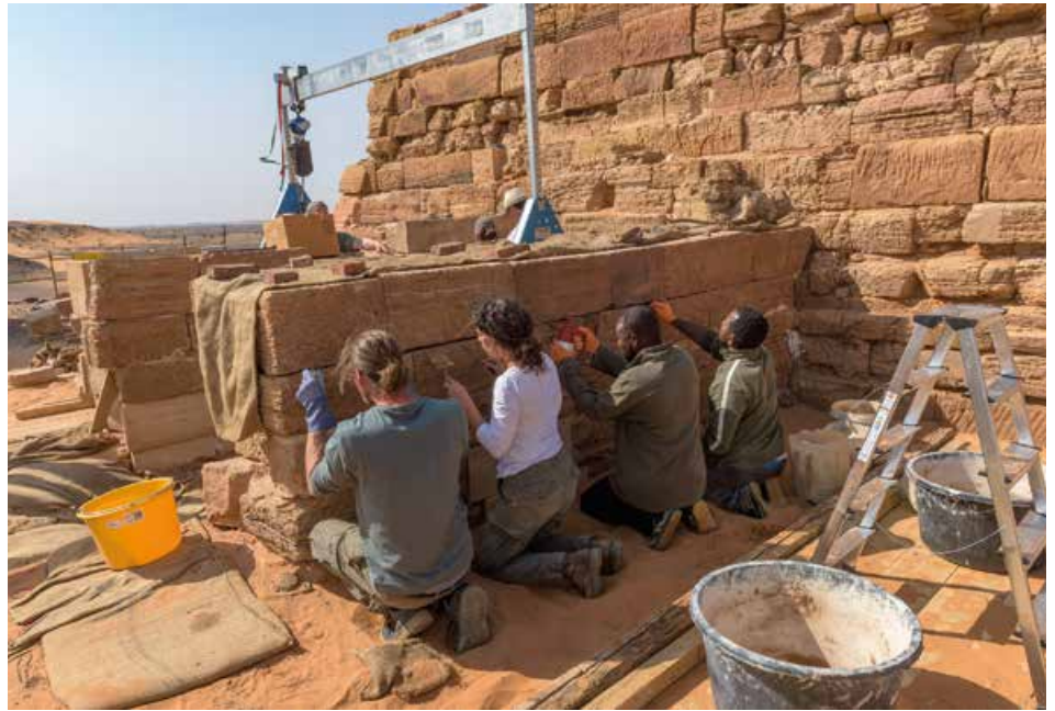
Abb. 5a, b: Sudanesische und deutsche Restauratoren arbeiten zusammen am Erhalt der Pyramiden (© QMPS-DAI-Projekt, Fotos: Pawel Wolf (rechts), Dunja Rüt (unten))
