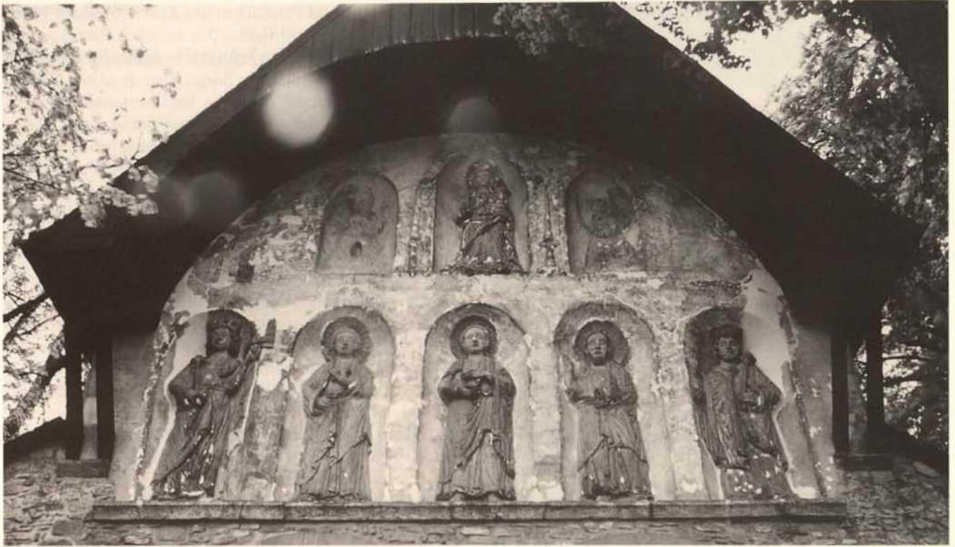
Abb. 189. Goslar, Vorhalle der ehem. Stiftskirche St. Simon und Juda, Giebfeld. Zustand nach Abschluß der Konservierung mit hell sich abzeichnenden Kalkmörtelergänzungen (1990).
