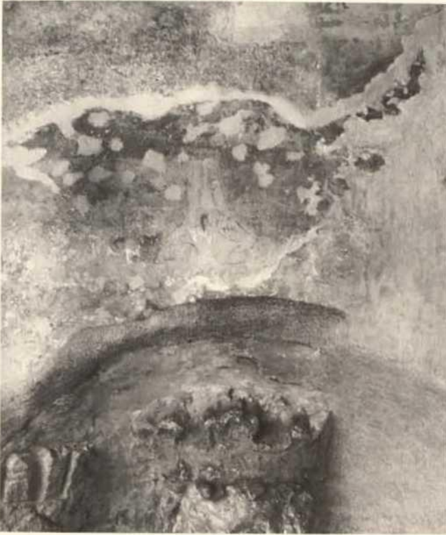
Abb. 188. Goslar, Vorhalle der ehem. Stiftskirche St. Simon und Juda, Dokumentation älterer Fassungsschichten oberhalb der rechten unteren Nische: Reste einer gemalten gotischen Fialenarchitektur als Nischenbekrönung in Fehlstellen der barocken Schlämme.
