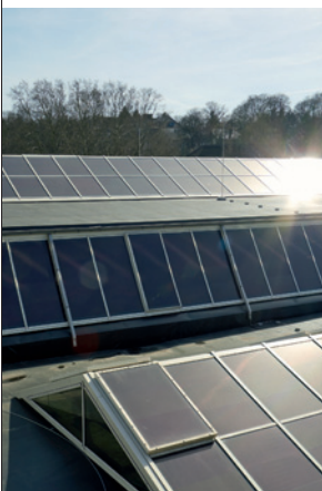
Photovoltaikanlage mit ASI® Modulen der Firma SCHOTT auf dem Dach des Museums für Antike Schifffahrt.
