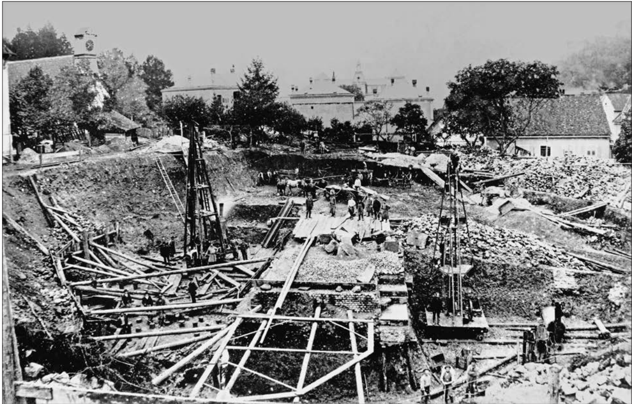
Abb. 4 Badenweiler: Blick nach Westen auf die Kirchenbaustelle von 1894. In der Bildmitte römisches Originalmauerwerk, das im Untergrund belassen wurde. Die Holzverstrebrungen markieren Ost- und Südchor des entstehenden Kirchenschiffs. Zur Verfestigung des Baugrunds wurden damals ebenso wie in römischer Zeit Ramppfähle gesetzt. Links oben die zeitweilige Ersatzkirche, rechts hinten das ehemalige Schulhaus, das heute noch den Kirchplatz nach Westen begrenzt.
