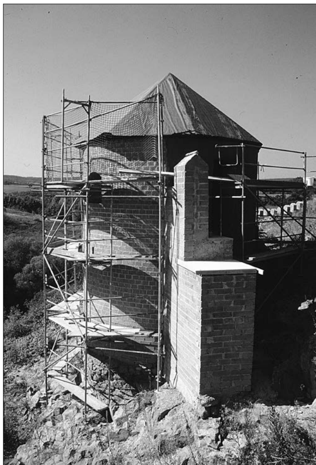
Abb. 13 Mayen, Katzenberg. Blick von Osten auf Turm 2 kurz vor dem Verputzen und dem Eindecken des Schieferdaches im September 2000. Die Form des Daches wurde nach originalen Befunden aus Turm 1 rekonstruiert.
