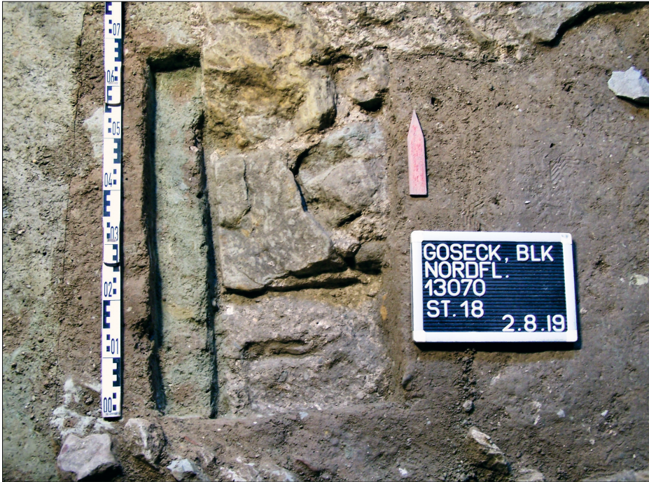
Abb. 6 Schloss Goseck, Burgenlandkreis. Die in einem Ausschnitt sondierte Westkante des Fundamentes Bef. 35. Erfasst wurde hier die untere Lage der sorgfältig gesetzten westlichen Außenschale. Das Fundament schneidet mit einer minimalen Baugrube direkt in den anstehenden blaugrauen Ton ein (vorn). Nach dem Abbruch der oberen Steinlagen wurde ein homogener mittelbrauner Lehm aufgefüllt (Bef. 27, im Bereich um die Fototafel), bevor der Fußboden des Seitenschiffes in Phase Ib darüber aufgebaut wurde.
