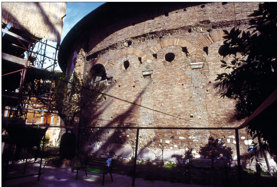
Abb. 24 Santo Stefano Rotondo in Rom, Italien. Westlicher Diagonalsektor mit Ausbruchsfries des abgeschlagenen Röhrengewölbes. Zustand 1996.
