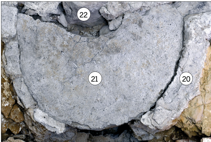
Abb. 15 Quedlinburg. Krypta St. Servatii. A 17364: Der eingegossene Estrich (Phase 2, Befund 21) schließt nicht sauber mit der Vierpasswandung (Phase 1, Befund 20).
