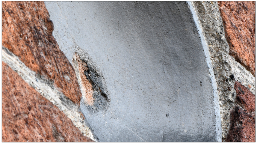
Abb. 11 Stiftskirche Jerichow. Abplatzungen, wie die an zentraler Stelle im Boden der nördlichen Schale, lassen den Scherben erkennen.
