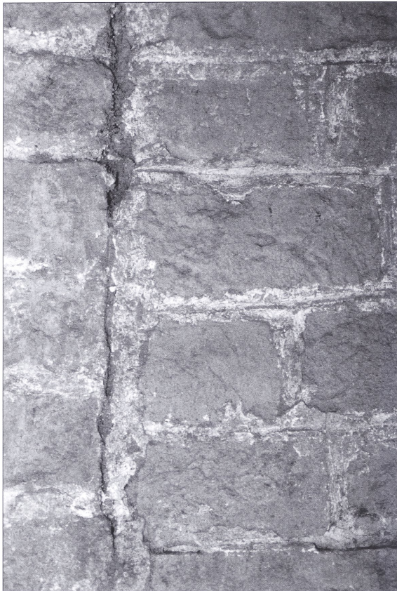
Abb. 26 Fugenritzen an der grabenseitigen Fassade des westlichen Fundamentes des Seehäuser Tores.
