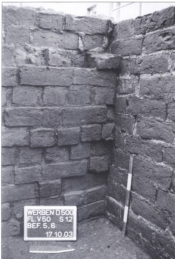
Abb. 27 Winkel zwischen dem Nordfundament des Seehäuser Tores (rechts) und einem auf dessen Innenseite nachträglich im rechten Winkel angesetzten Fundamentes (links).
