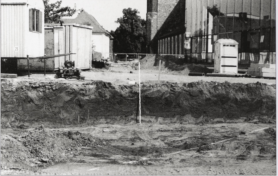
Abb. 21 Havelberg, Ldkr. Stendal. Erdabtrag für den zukünftigen Betriebshof der Stadtwerke 1999. Rechts Neubau der Stadtwerke; rechts hinten der Dom; links hinten Krankenhausaltbau (ehem. Propstei). Ansicht von Westen.
