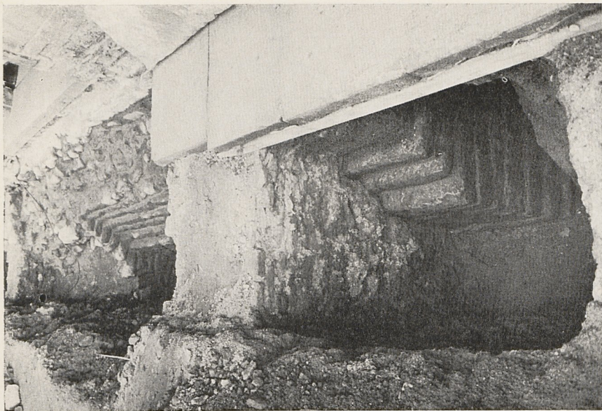
Abb. 3b Speyer, Dom: Nördl. Seitenschiff, Fundament vom 3. Joch nach Osten, 1968. Vorn die Nordwestkante des Langhauses Id, hinten der Fundamentblock, da- zwischen Maueransatz einer gotischen Kapelle (Foto: F. Klimm, Speyer)
