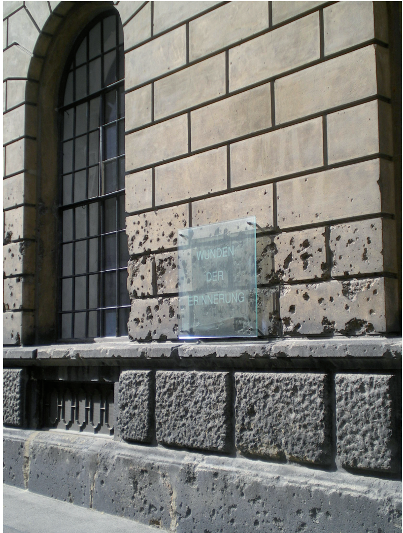
Abb. 3 Gottfried Semper und Carl von Hasenauer, Ehem. Kulissendepot der Hoftheater, 1874. Detail mit dokumentarisch belasteten Kriegsschäden von 1944/45 in der Romanzen-Quaderung von 1874. Wien 6, Lehárgasse 6–8 (Photo: Manfred Koller, 2012)
