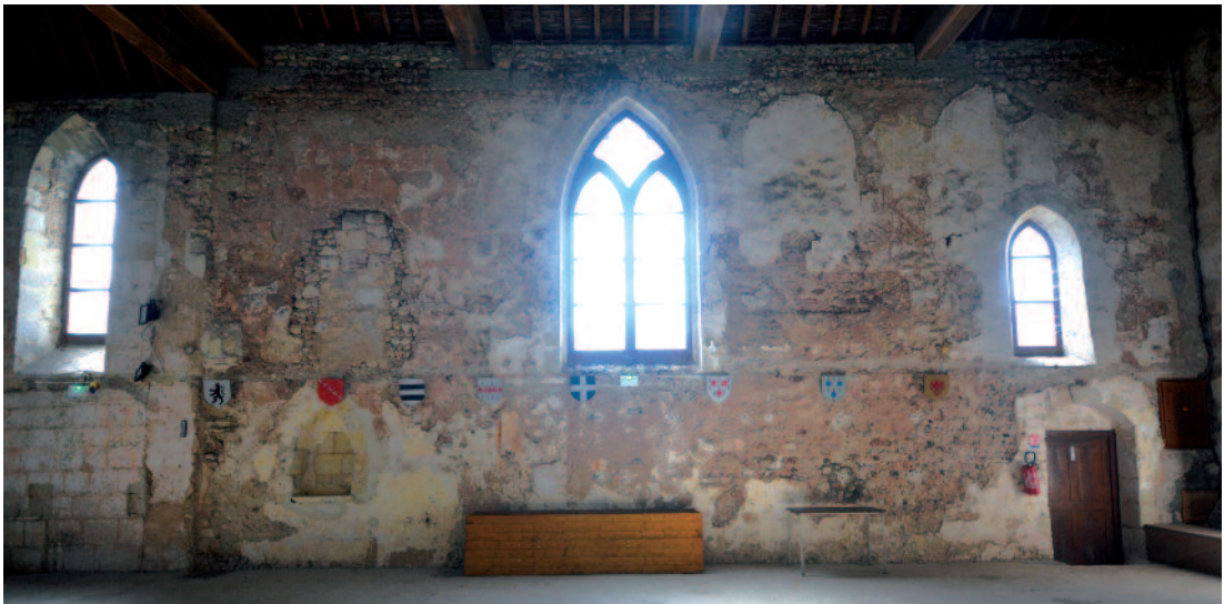
Abb. 4 Pfarrkirche in Artins, heutiger Zustand der südlichen Schiffswand, an der sich die Malerei befand (Foto: G. Ulrich Großmann, 2018)
