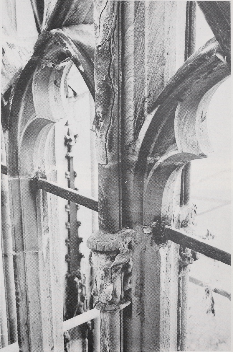
Abb. 4 Bacharach, Wernerkapelle. Maßwerk im Chor, Zustand 1982 (LA 1546/35)
