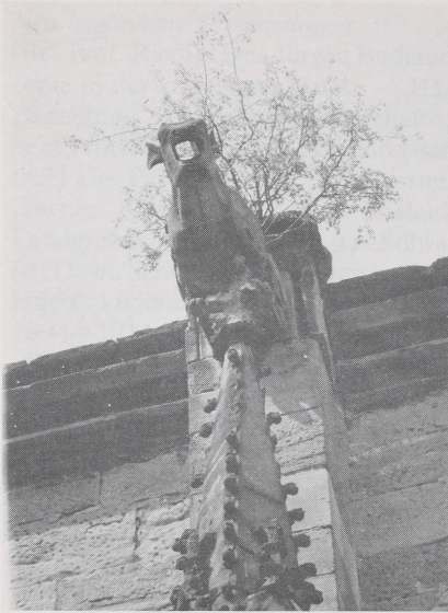
a) Wasserspeier an der Südseite des Chors, Zustand 1980 (Wolff)
