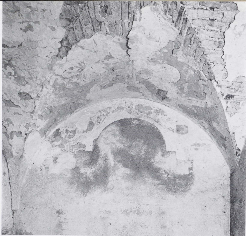
Abb. 5a München, Hofgarten, Arkadengebäude. Innenseite der Nordwand (By. Landesamt f. Denkmalpflege, E. Lantz)
