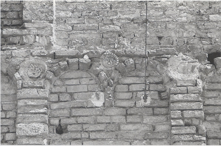
Abb. 4a Pavia, Torre Civica, Westseite mit vermauerten Schalen 1978 (Autenrieth)
