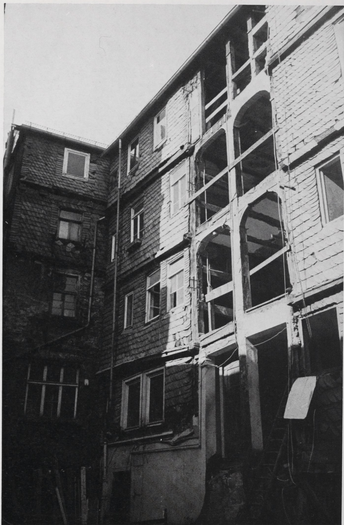
Abb. 2 Marburg, Aulgasse. Die Marburger Fachwerkhäuser sind überwiegend verschiefert. Bei der Entfernung jüngerer Anbauten wird die alte Rahmenstruktur sichtbar, die erhalten bleiben soll
