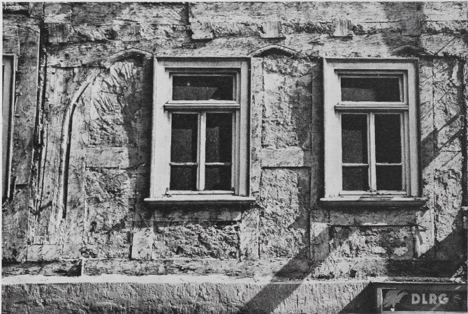
Abb. 4b Marburg, Fachwerkhaus (um 1500), später verändert. Bei der Freilegung der Fassaden kommen die ursprünglichen Spitzbogenöffnungen zum Vorschein, die in der Restaurierung wiederhergestellt werden
