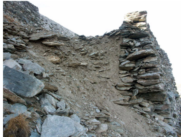
Abb.21: Trockenmauern der Faldumalp im Prozess der Verfalls aufgrund fehlender Unterhaltung (Falser 2007).
